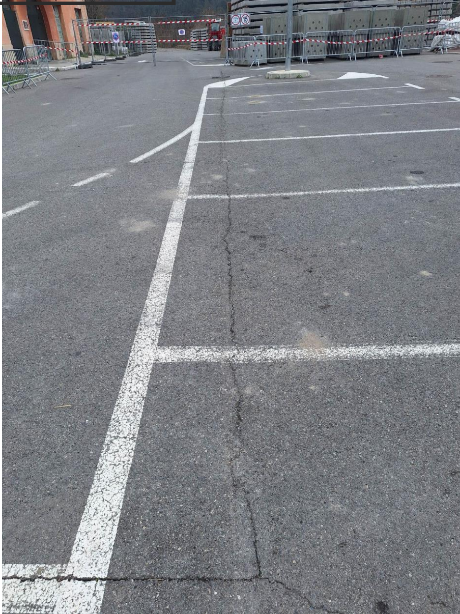
Figure 7 : Photographie de la fissure mentionnée dans l'état des lieux (vue du nord du parking)
